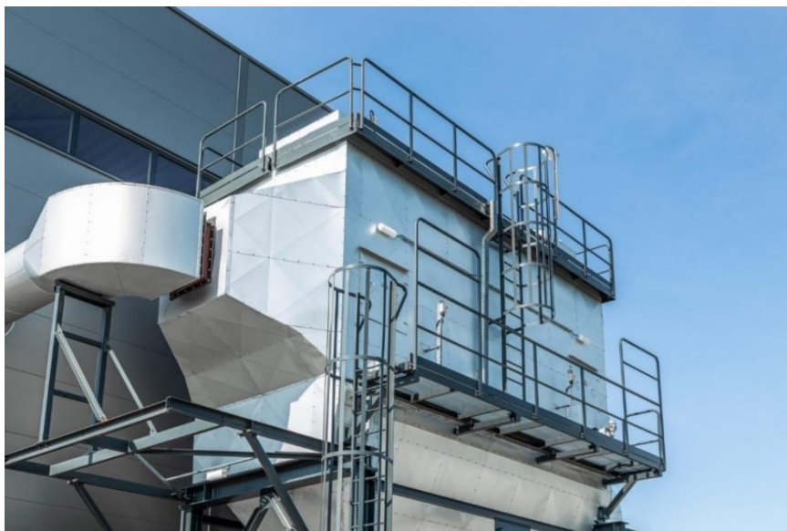
28 pav. Pavyzdinis dūmų kietųjų dalelių elektrostatinis filtras
